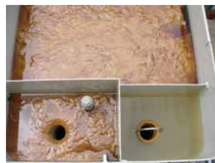
図 14 回収した油および鉄分の状況 （油水分離器内部状況）
