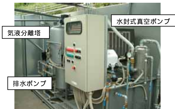
図 5 気液分離塔・水封式真空ポンプ および排水ポンプ
