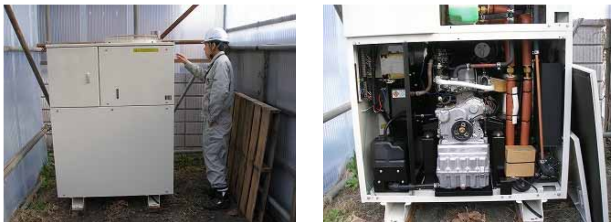
図 1 および図 2 ガス処理装置全景（左）およびエンジン部分拡大写真（右）
