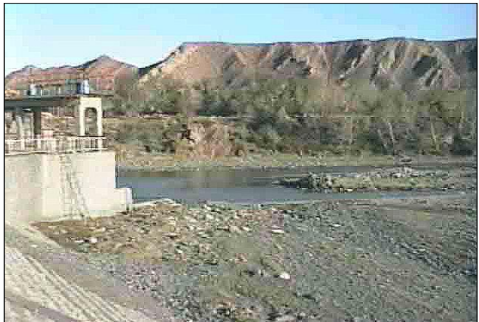
写真9 土砂で埋った水庫
