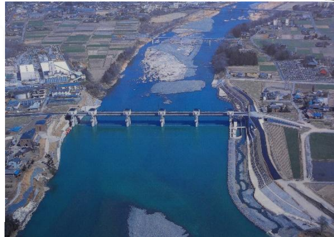
六堰頭首工の下流河床に露出する上総層群の泥岩
