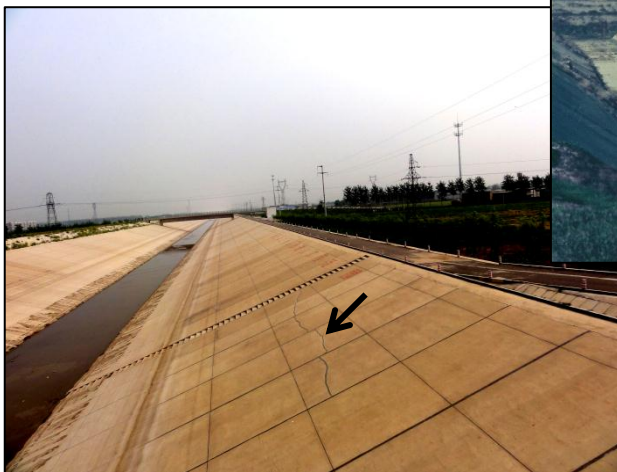
写真 24 南水北調導水路壁面にみる亀裂 (石家荘の北方、滹沱河付近、矢印の亀裂に注目)
