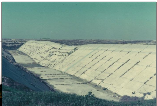
写真 23 特殊土地帯の導水路の変形 [導水路の亀裂からの漏水によって生じた沈下と破壊、1976年筆者撮影]
