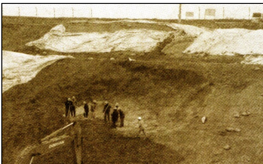
写真8 工事中渠道斜面に発生した滑落③
