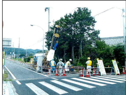
写真 30 路面陥没対策工事 多治見白川線大庭交差点 (出典：飛島・栗山建設共同企業体資料)
