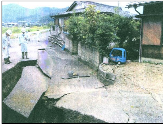
写真 29 道路陥没 平成 22 年 10 月 顔戸地区で発生 (出典：御嵩町役場資料)
