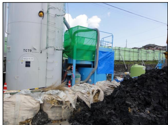
写真 37 充填材製造プラント (手前セメントサイロ、前方充填材製造装置)
