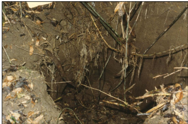
写真 2 陥没孔の孔底 (水路になっていて水が流れている。⇒印)
