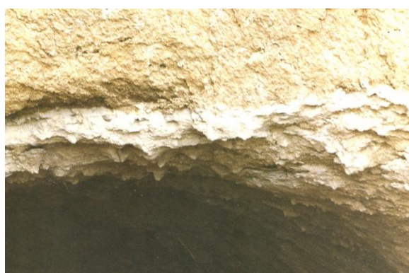
写真 11 出水口③、空洞の疑似鍾乳石 (陝西省咸陽市乾県)
