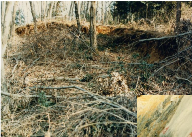
写真 70 斜面頂部の陥没
