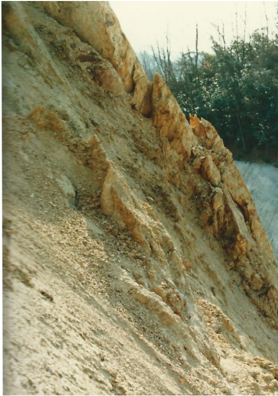
写真 68 トップリングによる崩壊
