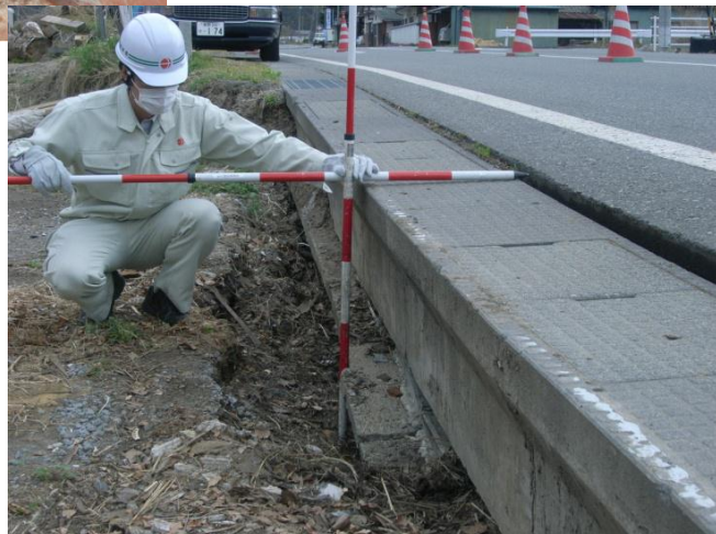
写真 89 千曲川右岸の道路変状
