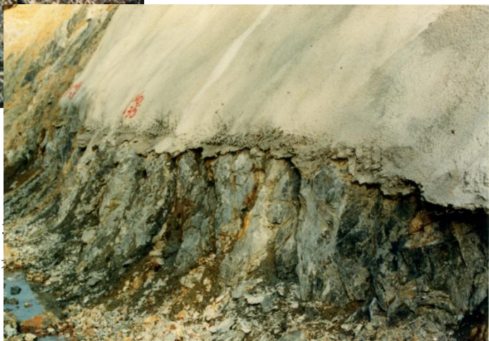
写真 71 モルタル吹付 斜面の下端部からの湧水
