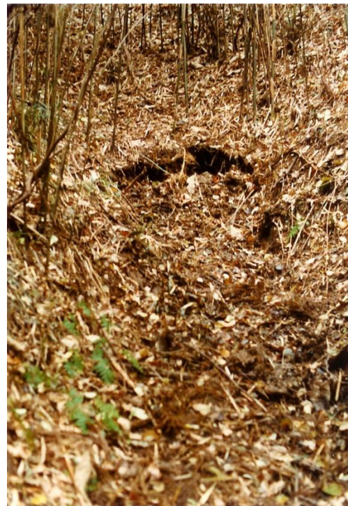
写真 53 パイプ網の陥没 (この下流部から水流が発生。川崎市早野)
