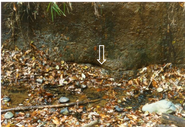
写真 56 河谷底に向かう“孕み出し” (クリープ状態で張り出してきたもの、八王子市長沼)
