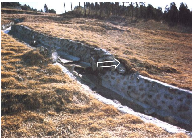
写真 54 オーバースラスト状の変位 (矢印) (千葉県嶺岡山地)
