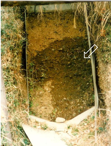
写真 59 60度斜面での滲出状況
