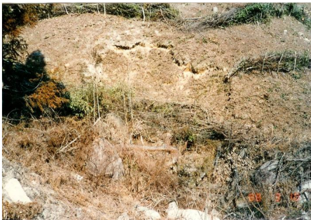
写真 52 表層部の基盤からの剥離 (基盤は花崗岩、剥離土層は 30 cm 程度。愛知県小原村)
