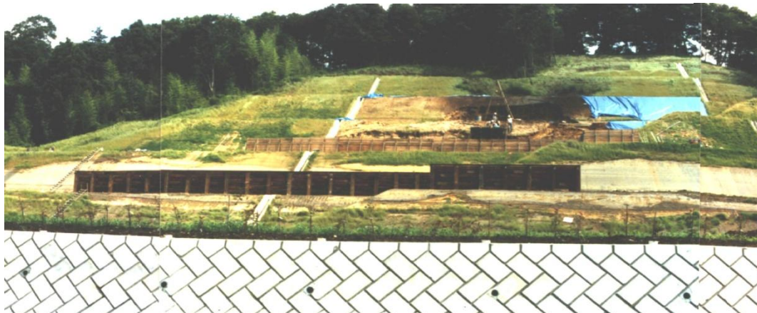
写真 44 露出した埋没谷に発生した崩壊 (数か月後)
