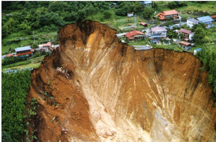
写真 65 崩壊後出現した透水ゾーン
