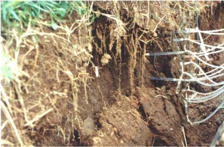
写真 29 トレンチの下部に発生した崩壊
