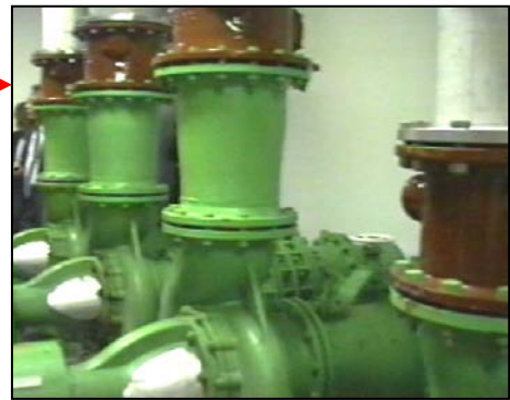
ポンプステーション
