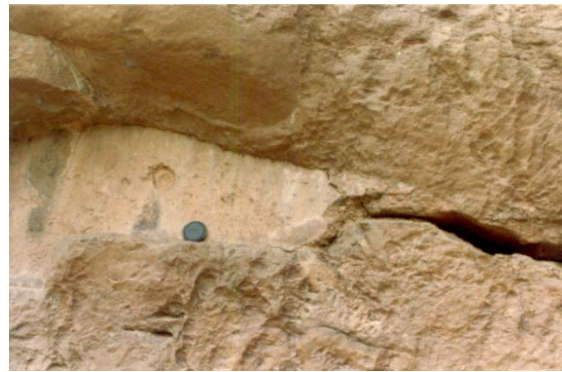
写真20 岩盤の割れ目を埋める漆喰
