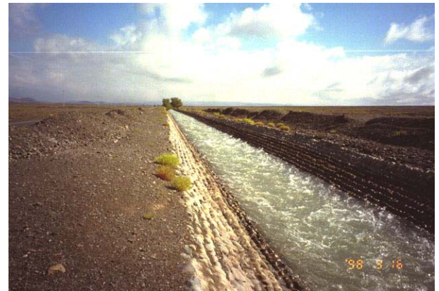
写真17 三面張りの明渠
