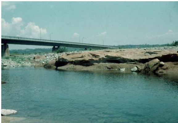
写真3 多摩大橋付近の河床低下
