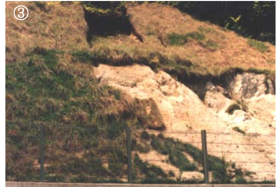
③ まず表層崩壊が発生、1年後基盤（マサ化花崗岩）崩壊に発達
