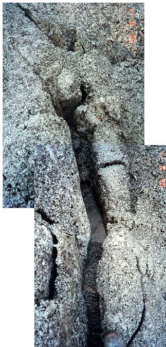
写真11 岩盤弱風化部にみる亀裂と地中水
